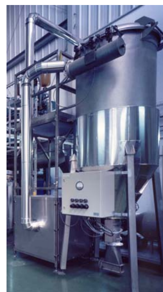
Instalación recién montada
