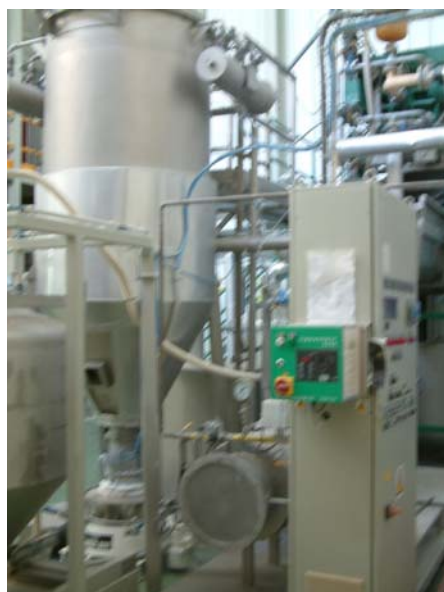
Estado actual. Filtro de mangas y cuadro de control.
